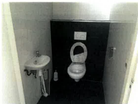
Foto van het toilet
