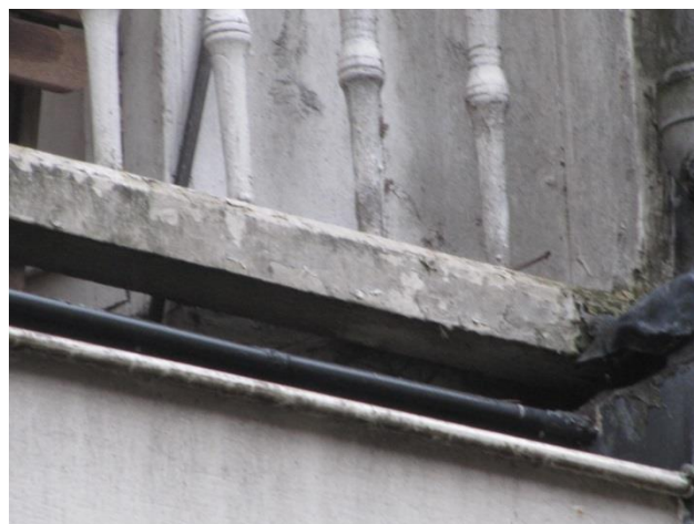
Foto 6: Houten hekwerken vertonen houtrot
