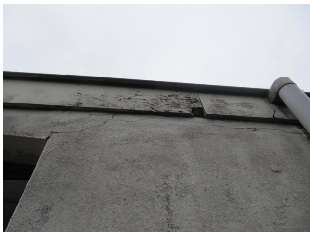
Foto 5: Dakrandbetimmering achtergevel vertoont houtrot
