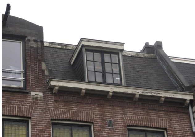
Foto 3: Gooten dakrandbetimmering vertoont houtrot
