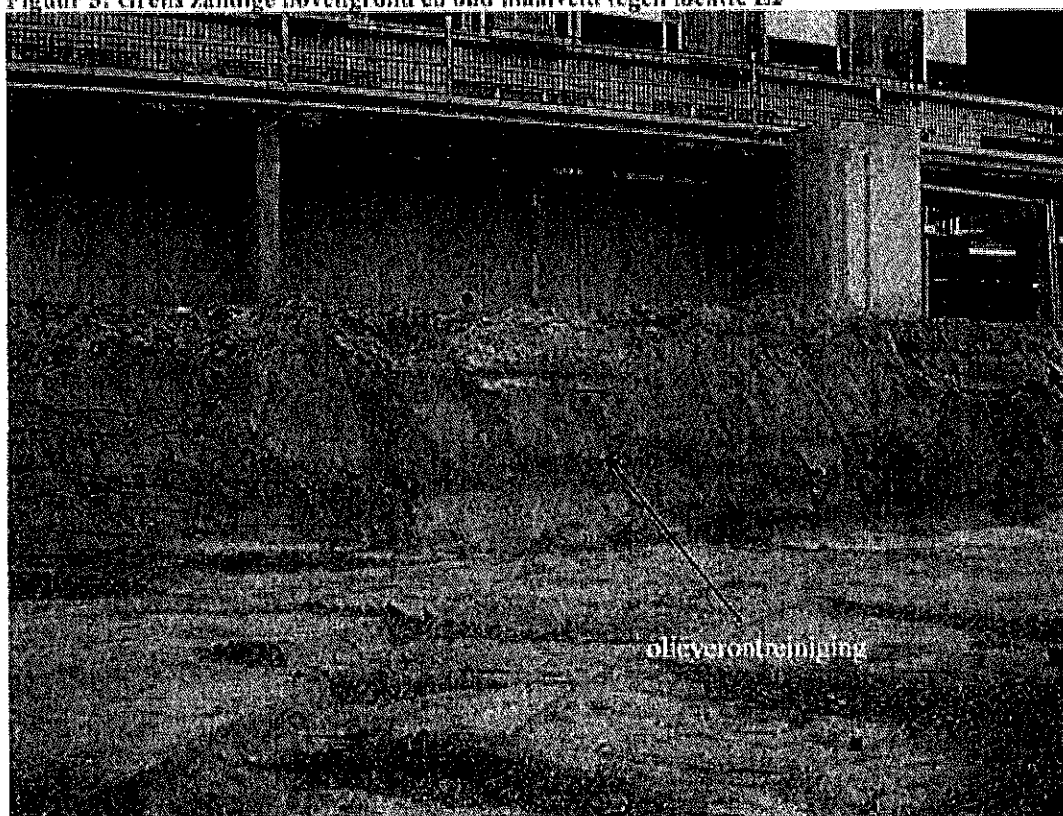
Figuur 6: Olieverontreiniging in talud locatie E2 (tegen gebouw Pruisenhof I)
