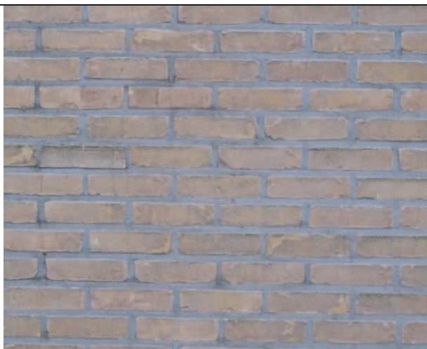
Foto 2. Het metselwerk is al eens hersteld.
