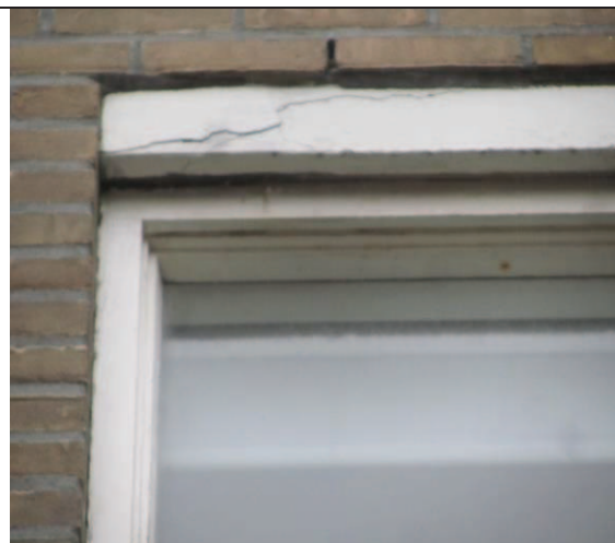
Foto 1. Scheur in een betonlatei.
