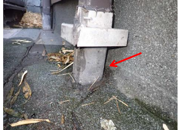
Afb 17. Aanzicht geringe ruimte tussen baluster en dakrand.
