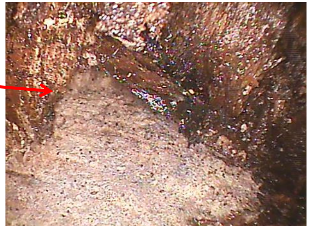
Afb 8. Aanzicht aangetaste houten raamwerk onder de pui.
