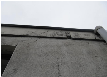
Foto 5: Dakrandbetimmering achtergevel vertoont houtrot
