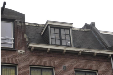
Foto 3: Gooten dakrandbetimmering vertoont houtrot
