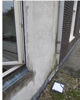
Foto 4: Hemelwaterafvoer, deel ontbreekt
