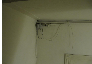
Foto 2: Plaatselijk losse kabels / bedrading trappenhuis
