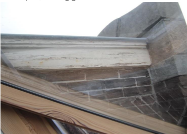
Foto 5: zicht op houten dakranden, schilderwerk noodzakelijk
