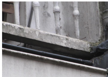
Foto 6: Houten hekwerken vertonen houtrot
