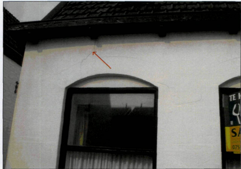
Foto 8: Doorgaande scheur vanaf de dakrand tot in de toeg van de voorgevel van nr. 42.
