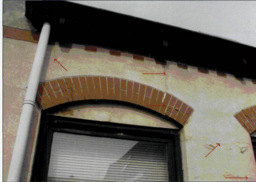
Foto 3: Doorgaande Scheur vanaf de dakrand tot in de toog bij nr. 40 in de voorgevel. Ook scheur rechts van hemelwaterafvoer. Ook horizontale scheurvorming in het stucwerk ter plaatse van de muurdam rechts van het raam.
