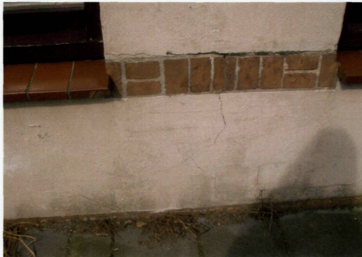
Foto 2: Scheur in de voorgevel bij nr. 40 in de borstwering
