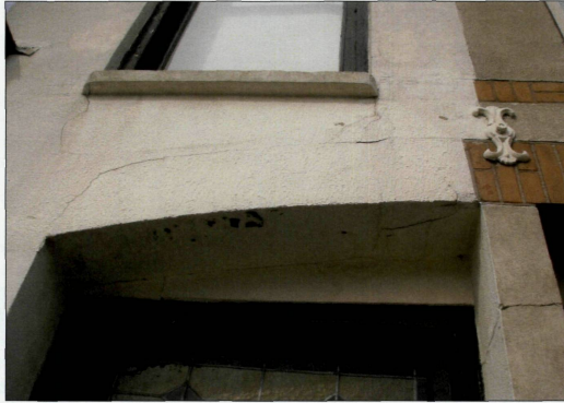
Foto 5: Diverse scheuren met name in de toog en de penant bij voorgevel nr. 42.
