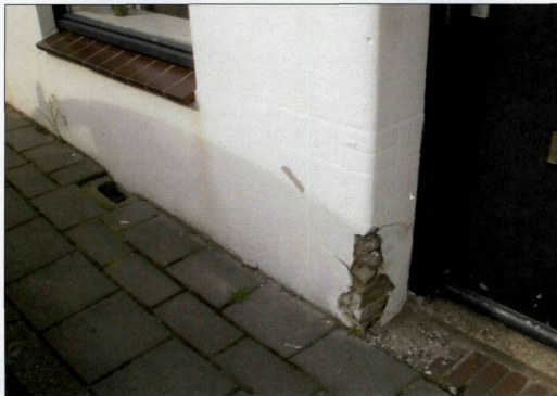
Foto 4: Losgekomen stucwerk nabij de voordeur van nr. 42.
