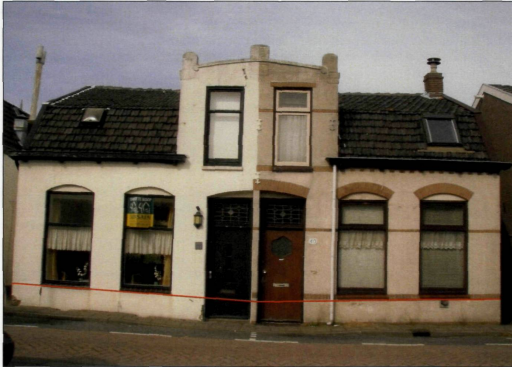
Foto 1: Voorgevels nummer 40 en 42. Duidelijk is de scheefstand c.q. verzakking te zien bij nummer 42 (links op de foto). Oorspronkelijk lagen de onderkanten van de raamkozijnen op 1 lijn.
