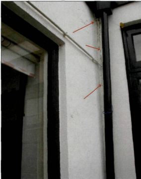
Foto 10: Scheurvorming aansluiting achtergevel-uitbouw nr. 42.
