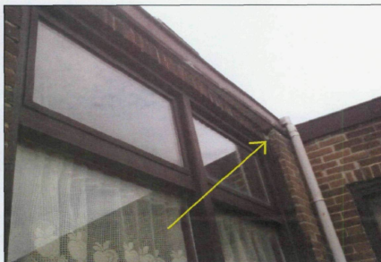
Foto 16: Kiervorming nabij aansluiting aanbouw nr. 40, mogelijk door uitgevallen lintvoeg.
