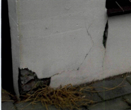
Foto 14: Scheurvorming in de rechterhoek van de straatgevel van nr. 42.
