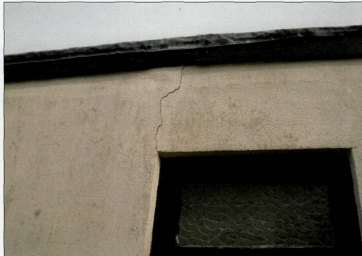
Foto 11: Doorgaande scheur vanaf de dakrand tot raamkozijn in de uitbouw van nr. 42.
