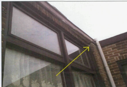
Foto 16: Kiervorming nabij aansluiting aanbouw nr. 40, mogelijk door uitgevallen lintvoeg.
