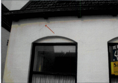
Foto 8: Doorgaande scheur vanaf de dakrand tot in de toeg van de voorgevel van nr. 42.
