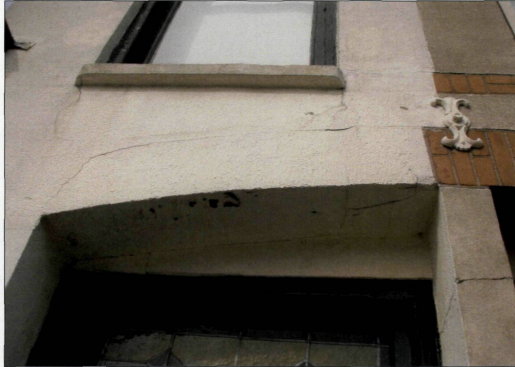
Foto 5: Diverse scheuren met name in de toog en de penant bij voorgevel nr. 42.
