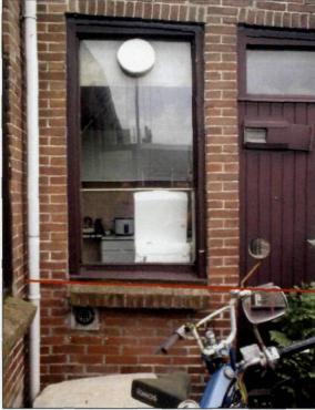
Foto 17: Zichtbare scheefstand in de aanbouw van nr. 40 onderkant raamkozijn.
