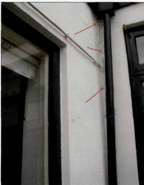
Foto 10: Scheurvorming aansluiting achtergevel-uitbouw nr. 42.
