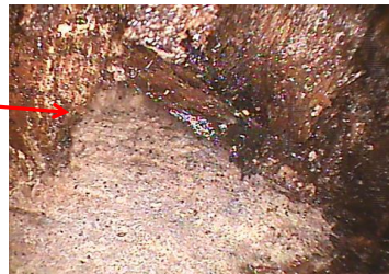
Afb 8. Aanzicht aangetaste houten raamwerk onder de pui.
