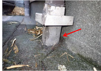
Afb 17. Aanzicht geringe ruimte tussen baluster en dakrand.
