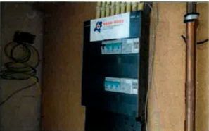
Foto van de meterkast
